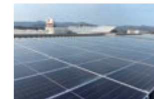
小坂井・茨城工場に太陽光パネルを設置し、2021年4月より発電を開始しています。
