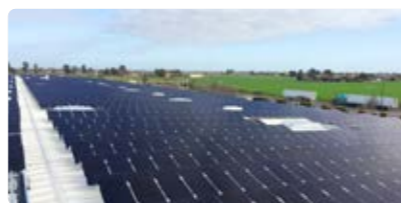
Kagome Inc. (米国)に設置した太陽光パネル
