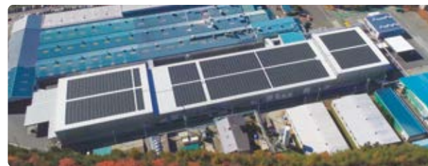
富士見工場(長野県)に設置した太陽光パネル
