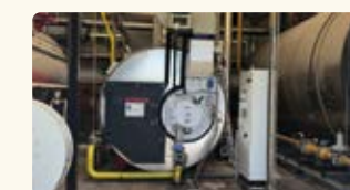
新型ボイラーの導入
