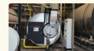
新型ボイラーの導入
