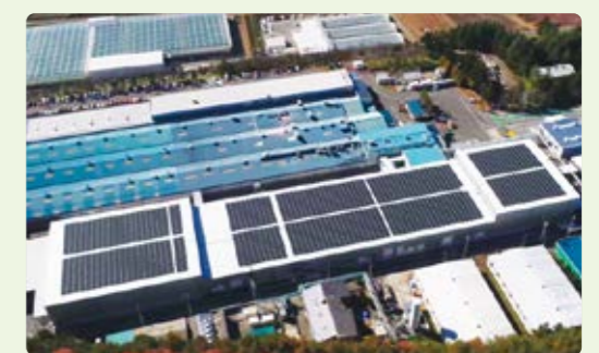
工場屋上に取り付けられた太陽光パネル
