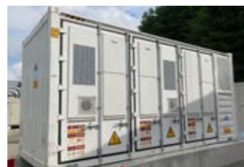
富士見工場に導入した蓄電池システム
