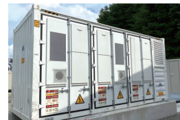
富士見工場の蓄電池システム
