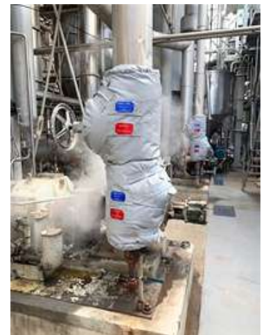
蒸気バルブの断熱
