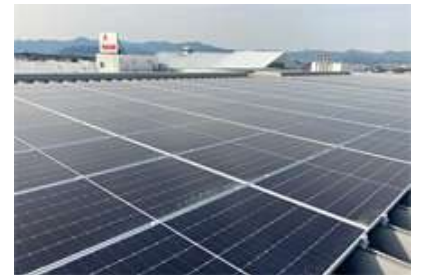
小坂井工場 工場屋根に設置した太陽光パネル
