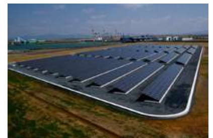
響灘菜園が受電している太陽光発電所
