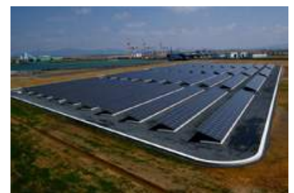
響灘菜園が受電している太陽光発電所
