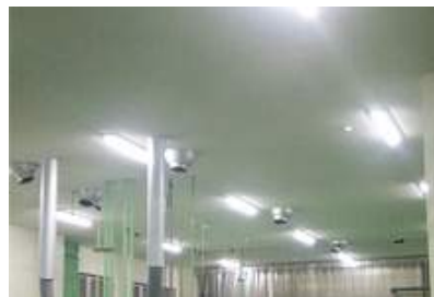
工場内照明のLED化
