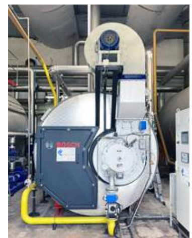
高効率のボイラーへの更新
