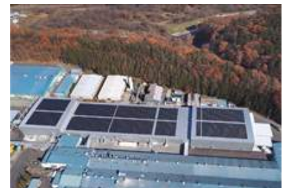
富士見工場 工場屋根に設置した太陽光パネル
