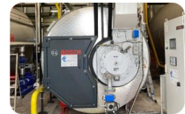
高効率のボイラーへの更新
