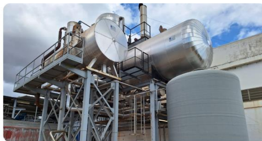
Italagro社の温水の回収タンク
