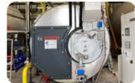
高効率のボイラーへの更新
