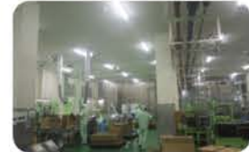
工場内照明のLED化
